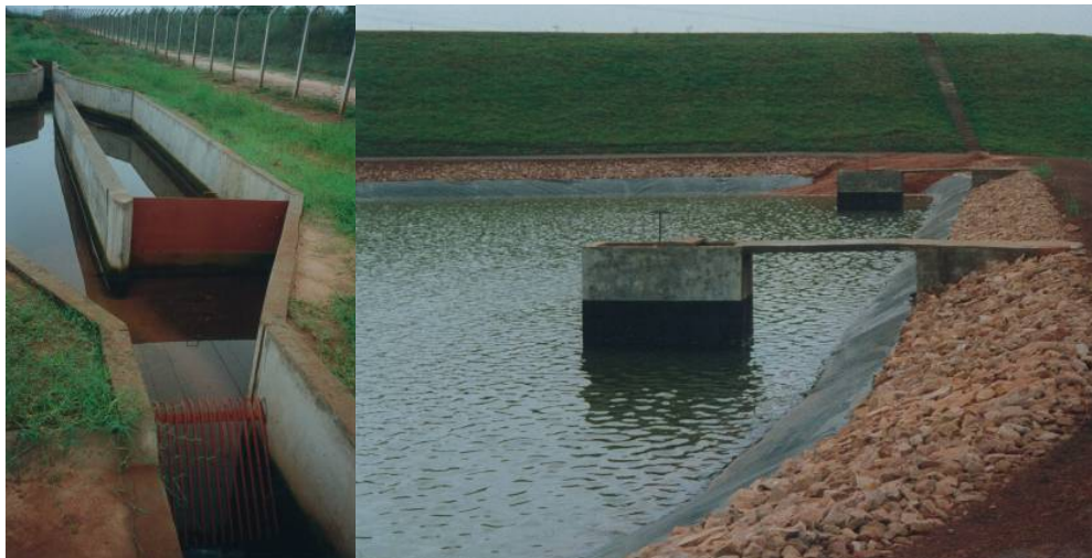
Abwasserreinigung: Zulaufrechen(l), Teichkläranlage, Auslaufbauwerk (r)
